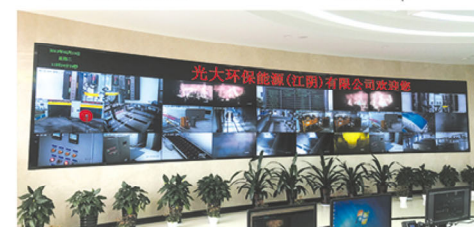
自动化控制系统 Automatic control system
