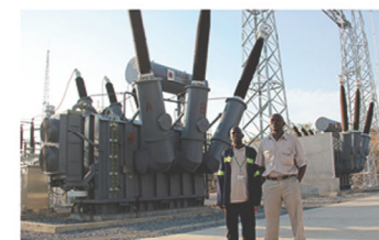
出口赞比亚卡里巴 (KARIBA) SFP-60MVA-330KV Transformer SFP-60MVA-330KV exporting to Zambia
