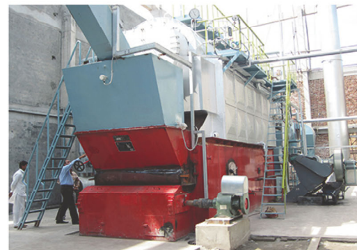
出口巴基斯坦DZL锅炉现场 (DZL10-1.25-AII) DZL Boiler Exporting to Pakistan (DZL10-1.25-AII)
