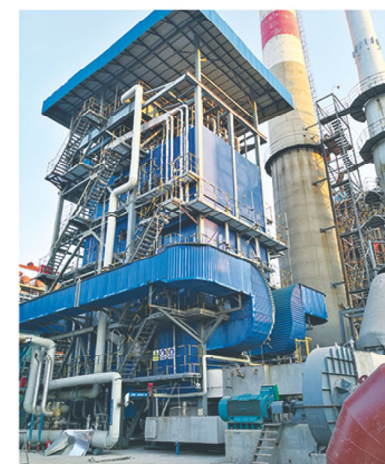
东方华龙75吨燃气锅炉 75 Ton Gas Fired Boiler
